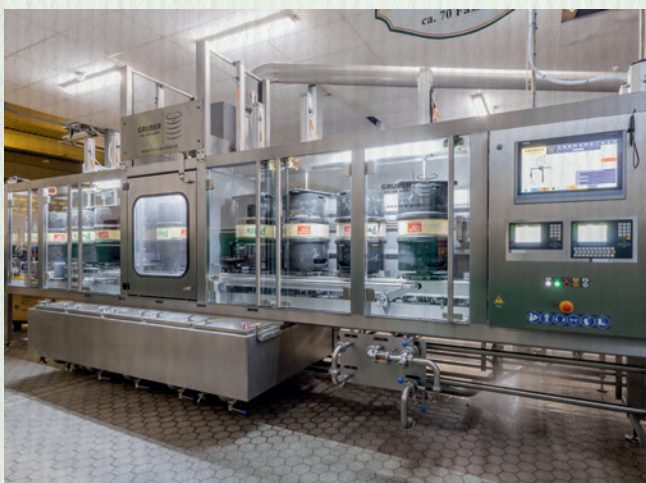
Die kompakte Anlage passt perfekt an den vorgegebenen Platz, unmittelbar angrenzend an die Logistik- und Lagerfläche.
